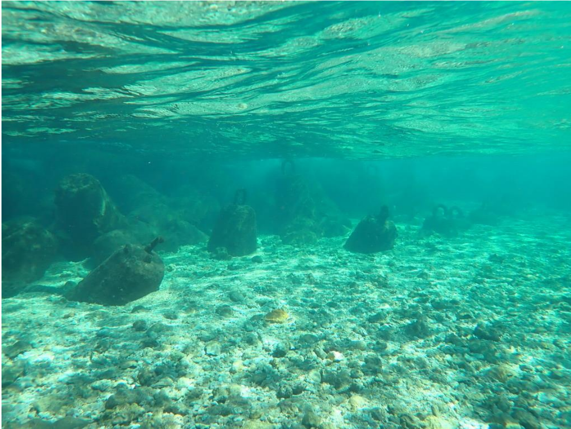
図 15 サンゴ砂礫によって埋没した鋼製消波ブロック.
